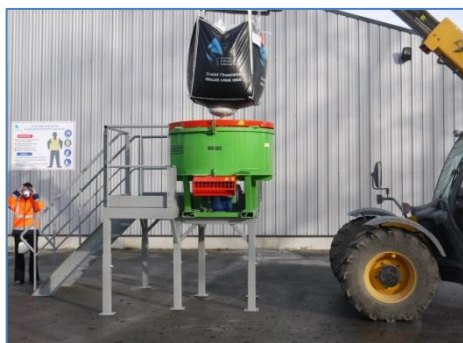
MINI-CENTRALE À BÉTON
