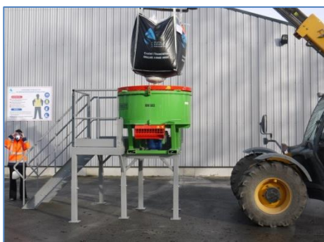
MINI-CENTRALE À BÉTON
